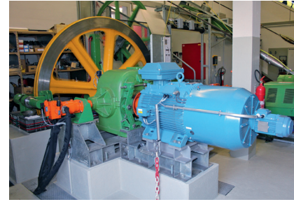
In der Talstation Ragnatsch befindet sich der 110 kW starke Antrieb.
