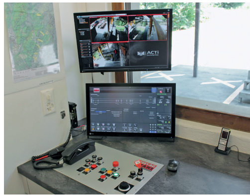
Im Jahr 2015 wurde in der Talstation Malans eine neue Steuerung und Fernüberwachung der Bergstation von Frey AG Stans installiert.
