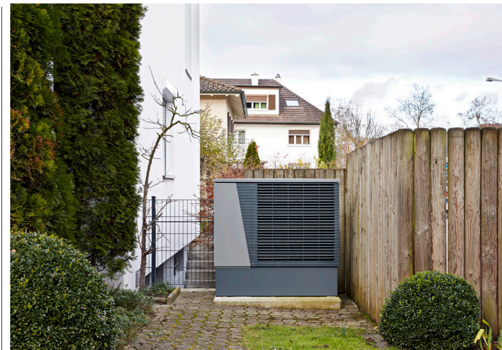
Aussen aufgestellte Luft-/Wasser-Wärmepumpe
