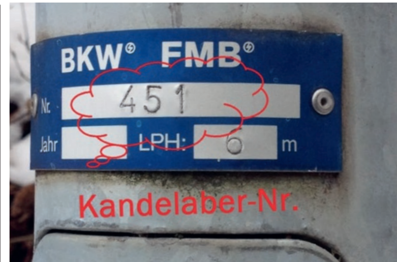
Die Kandelaber-Nummer ist auf einer Plakette am Mast der Strassenlampe abzulesen – sie ist bei der Behebung eines Schadens sehr hilfreich. Foto: zvg
