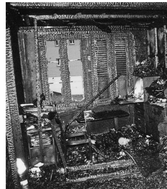
Das total ausgebrannte Gebäude
