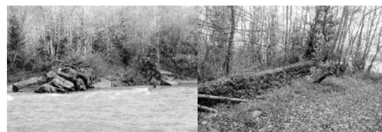
Unterspülte, teils eingestürzte Buhnen. Vom Flusslauf abgeschnittenes, stark eingewachsenes Bauwerk.
