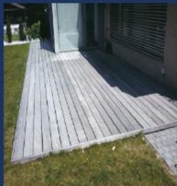
Verblasste und verschmutzte Holzterrassen grundreinigen...
