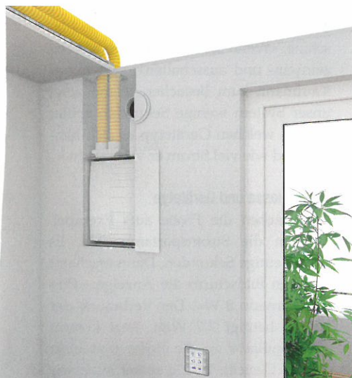
Eingebaute Komfortlüftung M-WRG U 2 mit Zweitraumanschluss.
