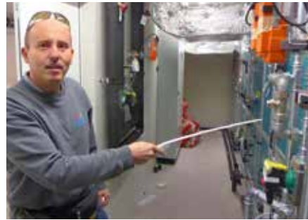
Mit dem komplexen Röhren- und Apparategewirr der Haustechnik – hier während des Umbaus des Hotel Eden – kennt sich Unternehmer Ueli Zimmermann bestens aus. Als Gemeinderat hingegen arbeitet er sich in manche neuen Themen ein.
