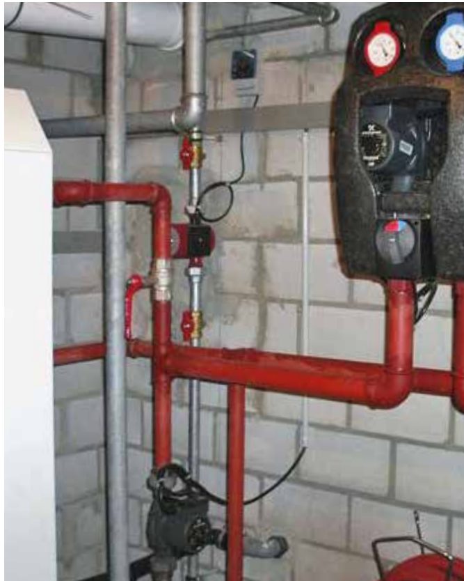
Neubau: Erdgastherme mit Boiler. Einsparung durch Weglassen Dämmung CHF 300.–. Mehrverbrauch in 25 Jahren CHF 600.–.
