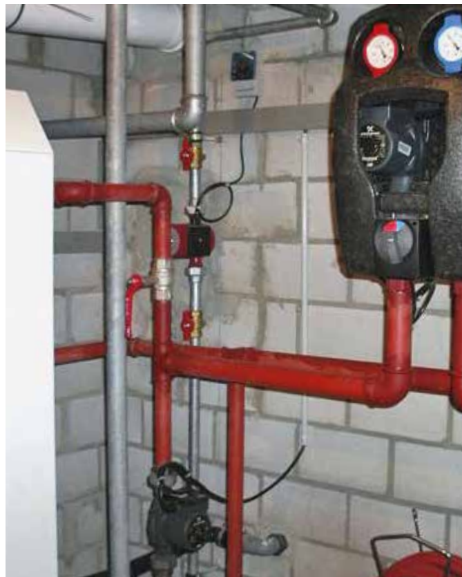
Neubau: Erdgastherme mit Boiler. Einsparung durch Weglassen Dämmung CHF 300.–. Mehrverbrauch in 25 Jahren CHF 600.–.
