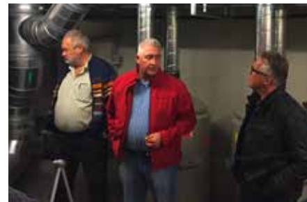
Peter Abplanalp, Fachbereichsleiter Zivilschutz und Kommandant Zivilschutz Spiez (Mitte), führt durch die Anlage. Hier ist die Lüftungsinfrastruktur zu sehen.
