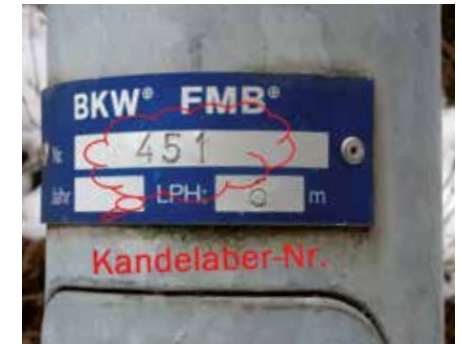
Die Kandelaber-Nummer ist auf einer Plakette am Mast der Strassenlampe abzulesen – sie ist bei der Behebung eines Schadens sehr hilfreich. Foto: zvg
