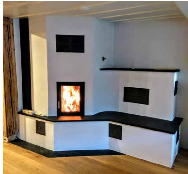
Ganzhausheizung mit Stückholz-Kesseleinsatz in Speicherofen
